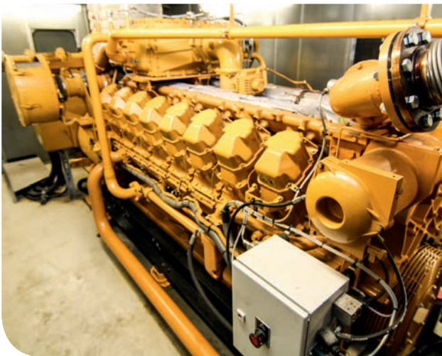
Gasverbrennungsmotor des Blockheizkraftwerks
